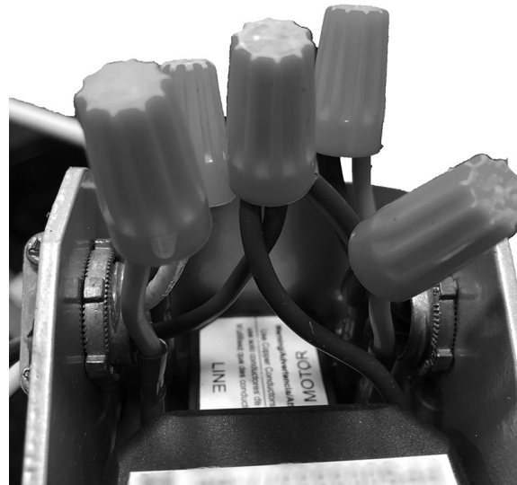
Figura 1: Cableado del dispositivo
